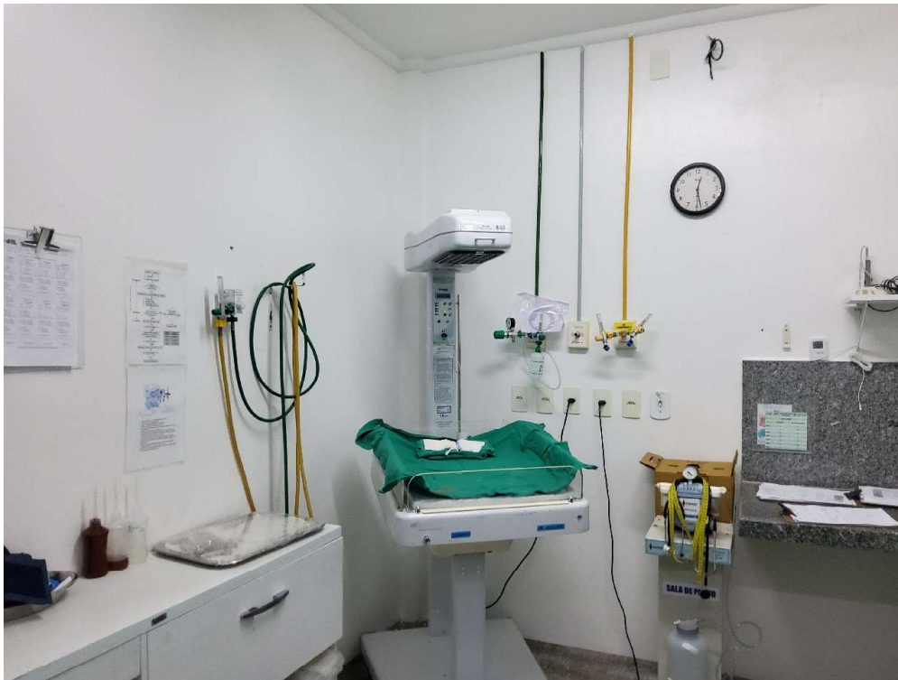
Rede canalizada (parede)
