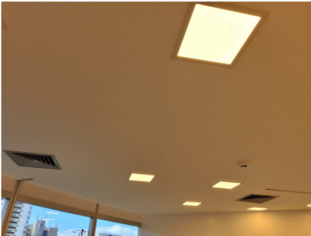
INFRAESTRUTURA - Ambiente climatizado
