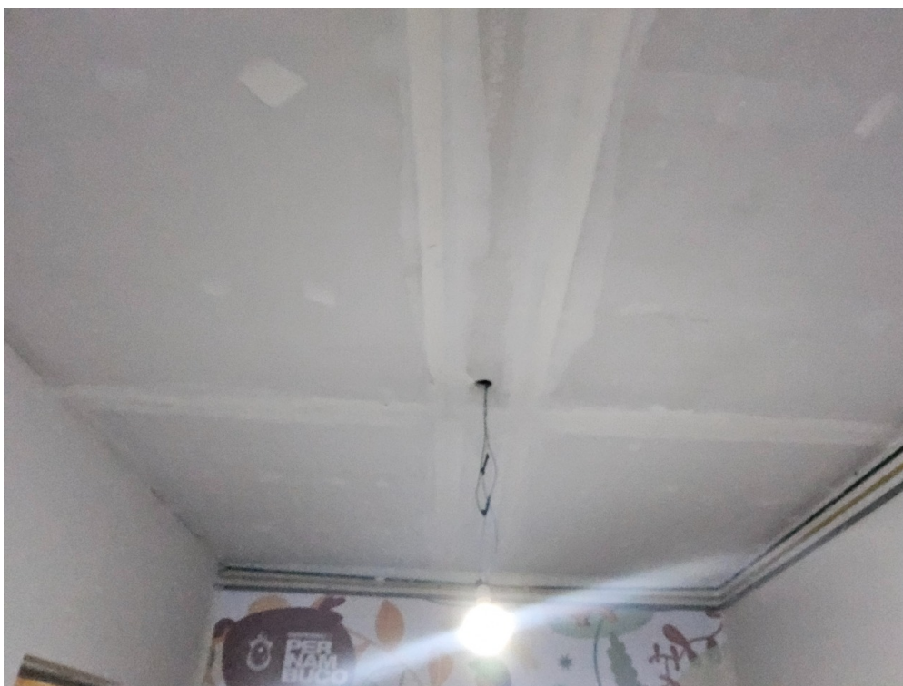
Imagem da 1ª constatação. Local informado que caiu a cobertura de gesso do teto.
