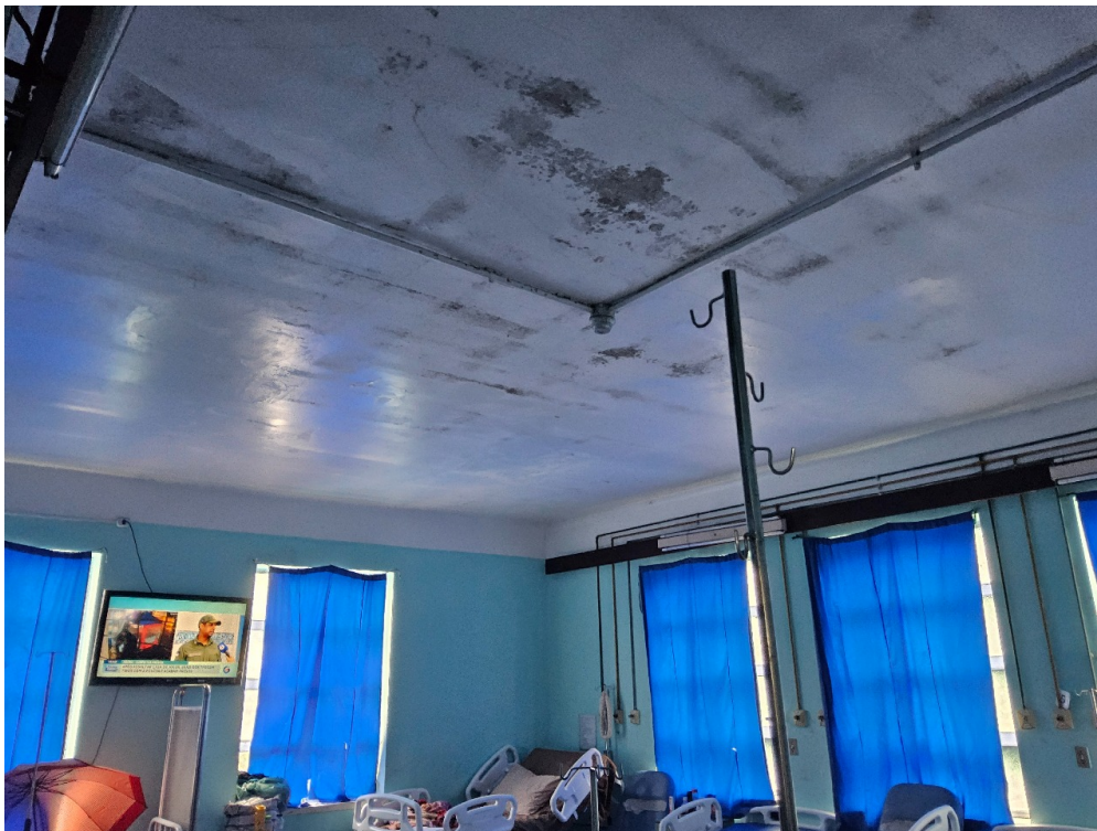
Imagem da 1ª constatação. Enfermaria.
