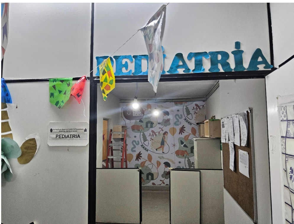
Imagem da 1ª constatação. Corredor de acesso às enfermarias de ortopedia pediátrica, local da queda do teto.
