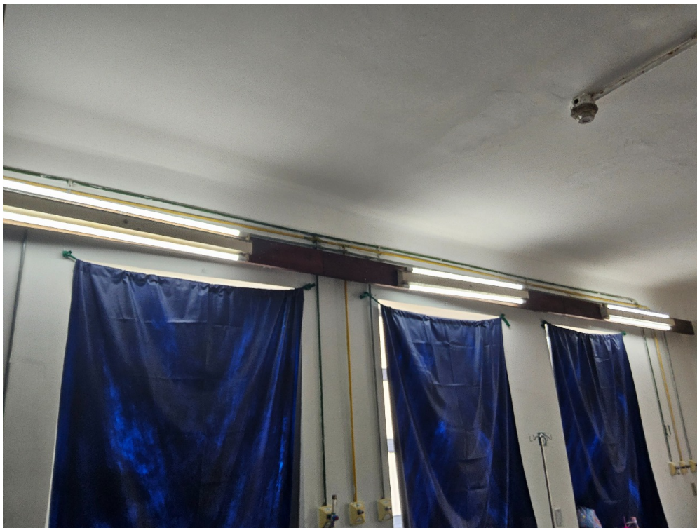
Imagem da 1ª constatação. Enfermaria
