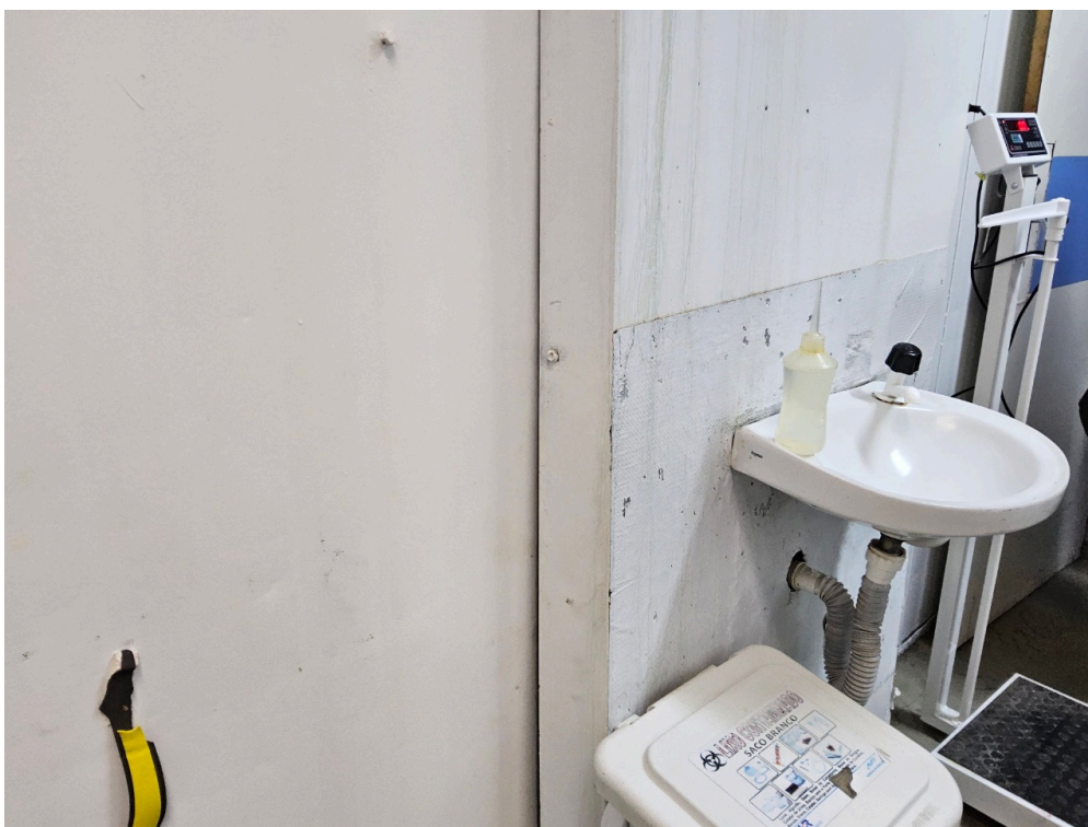
PIA DO CONSULTÓRIO/SALA DE CLASSIFICAÇÃO DE RISCO
