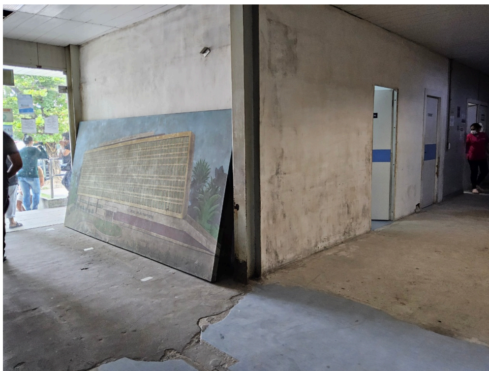
ENTRADA DA EMERGÊNCIA PEDIÁTRICA - corredor da recepção compartilhada (observar condições estruturais)
