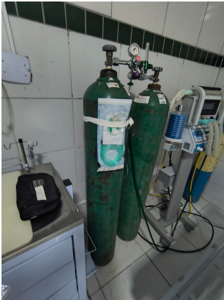
Cilindros de oxigênio na sala vermelha, sem fixação
