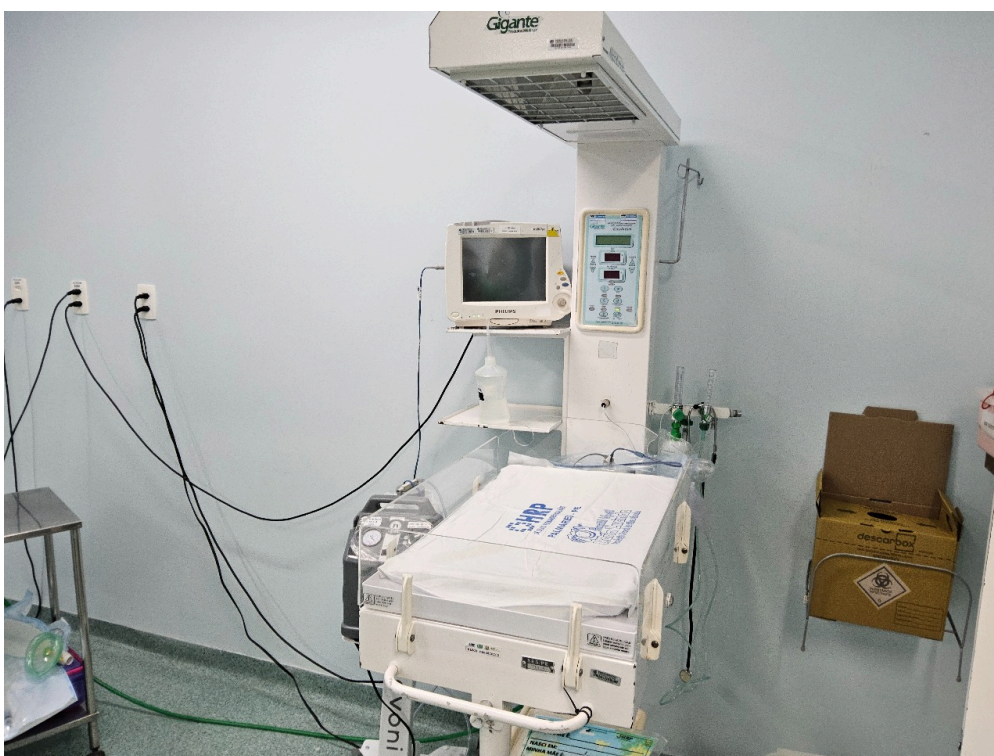
Centro cirúrgico obstétrico
