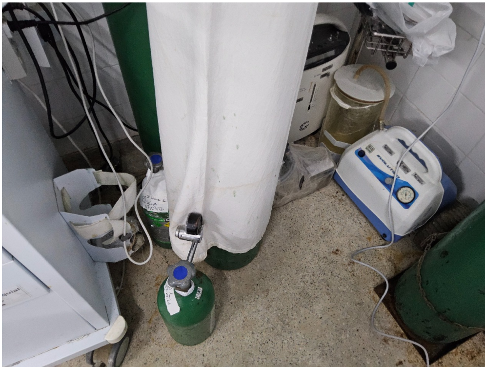
SALA DE OBSERVAÇÃO CLÍNICA - Cilindro(s)
