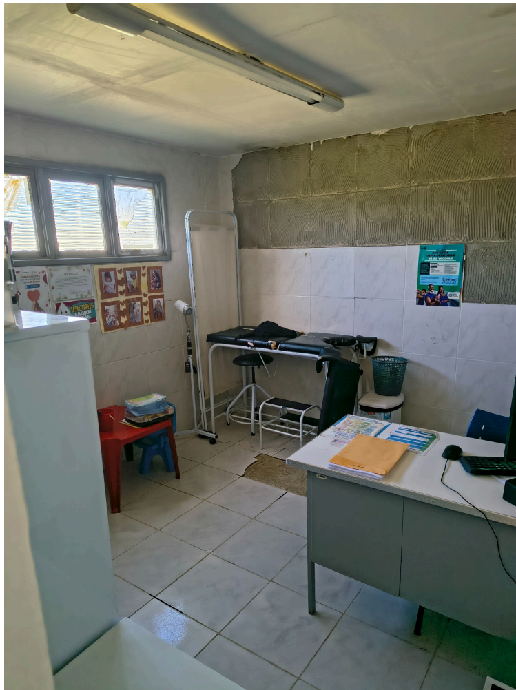
Consultório de enfermagem com problemas na alvenaria e sem climatização
