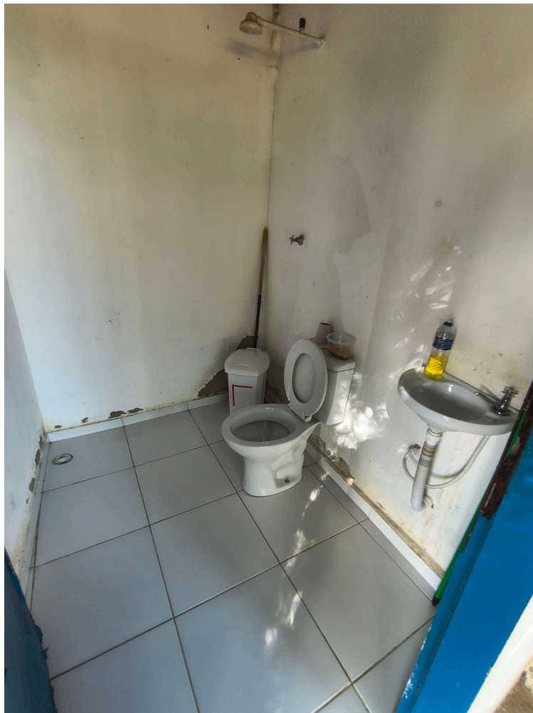
Banheiro único para usuário é externo (fica por fora da unidade) e sem sinalização
