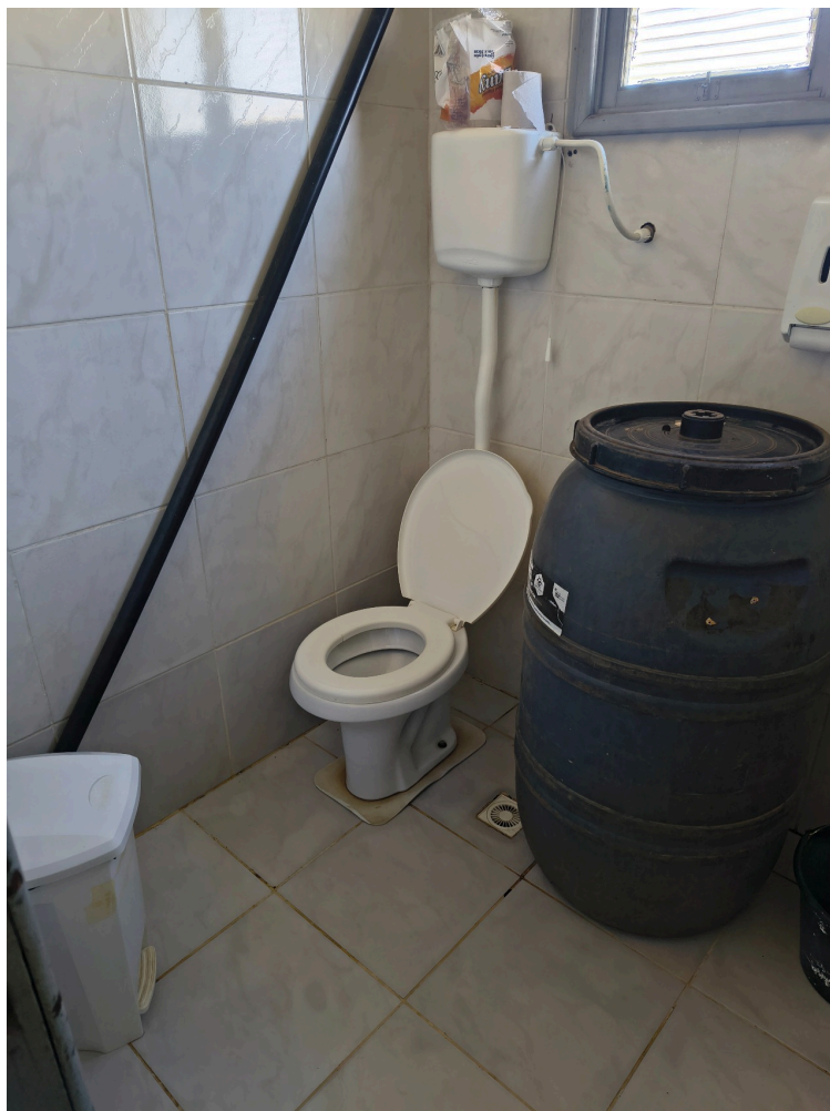
Banheiro único dos funcionários tem cilindro de resíduos sólidos (lixo biológico) armazenado no interior do banheiro
