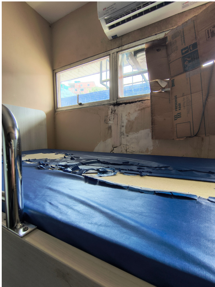
colchão com forro rasgado, infiltrações e mofo próximo ao ar condicionado que climatiza quarto de plantonistas
