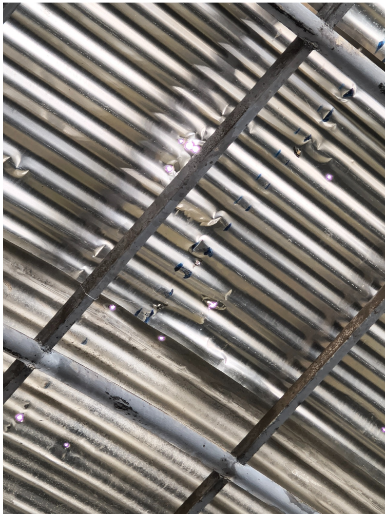
perfurações do telhado em imagem ampliada
