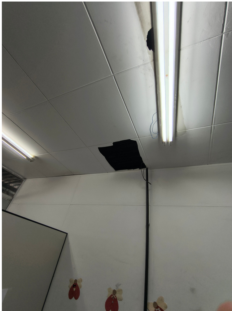
Abertura no forro de gesso da sala de classificação de risco
