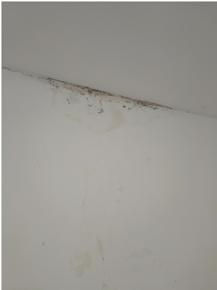
Áres com Infiltrações e Mofo
