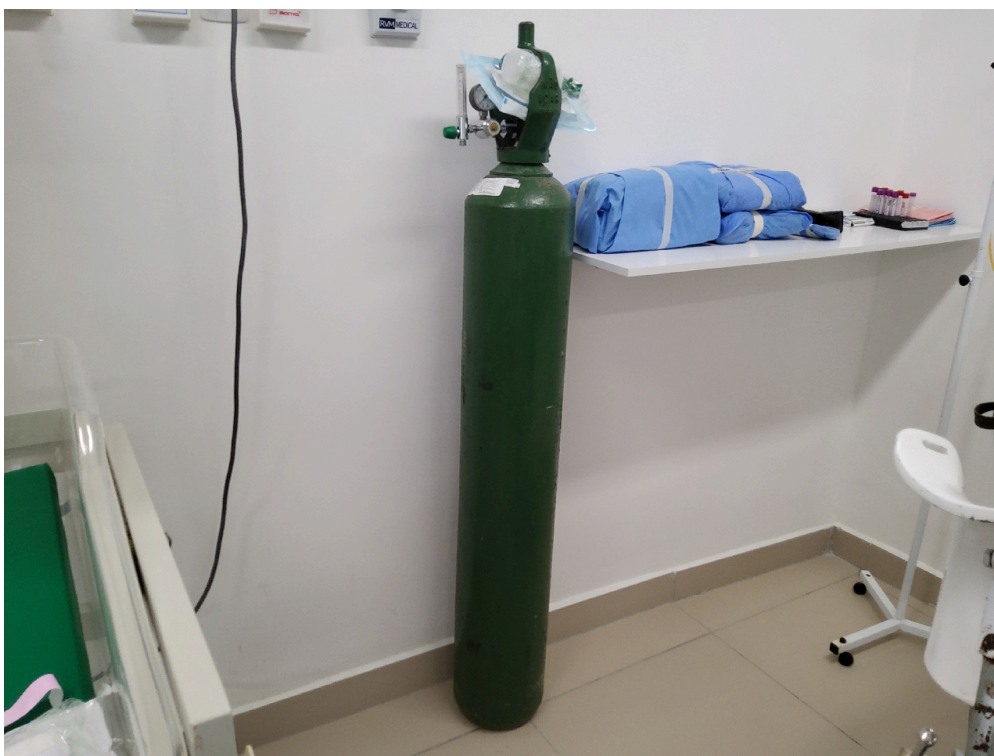
ATENDIMENTO AO RECÉM NASCIDO – cilindro não fixado à parede ou em suporte apropriado para tal
