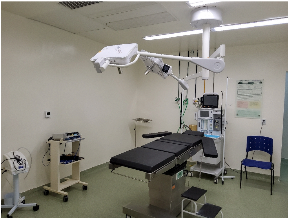
BLOCO CIRÚRGICO - SALA 1
