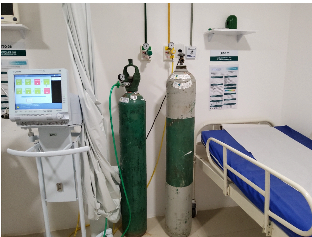
CILINDRO DE OXIGÊNIO- não fixado à parede ou em suporte apropriado para tal
