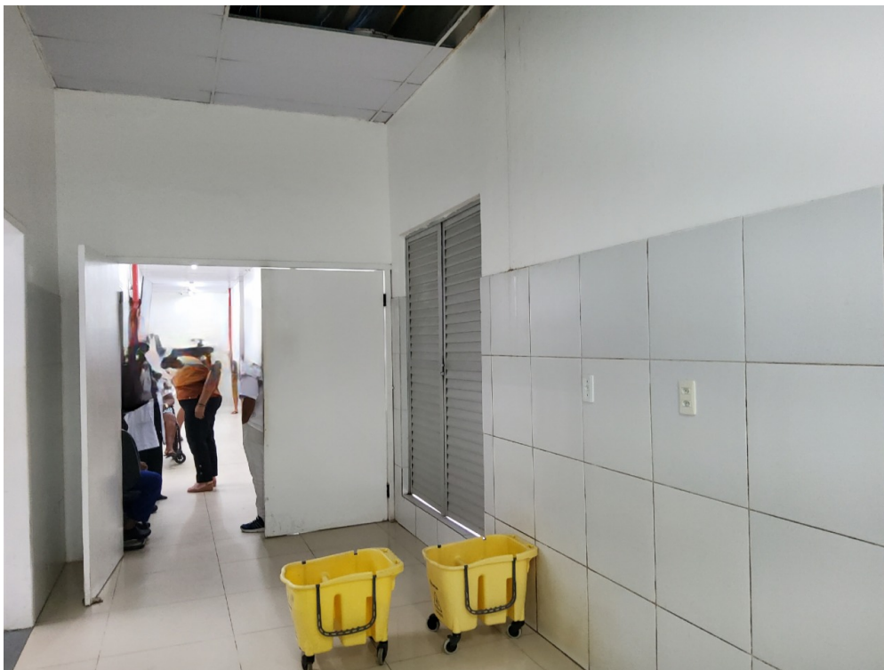
Teto com goteiras (observar baldes onde a água é recolhida)
