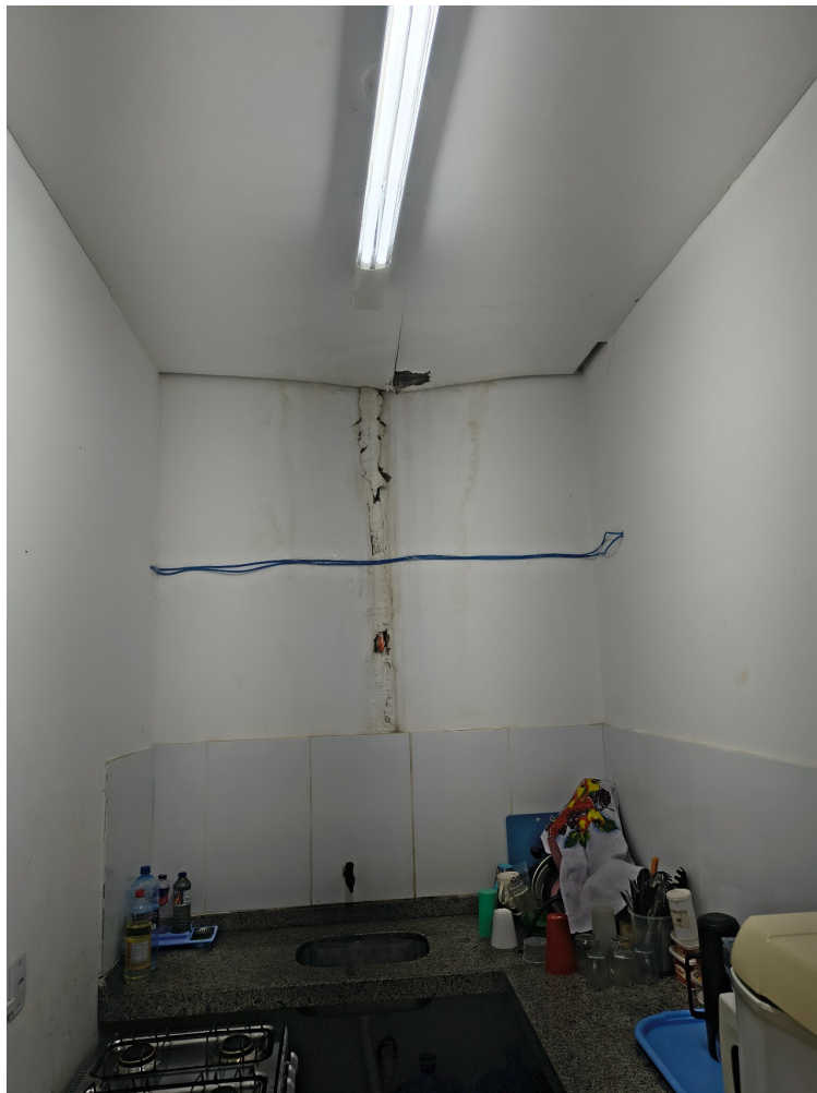
Copa / cozinha em ambiente sem aeração, com infiltrações e mofo
