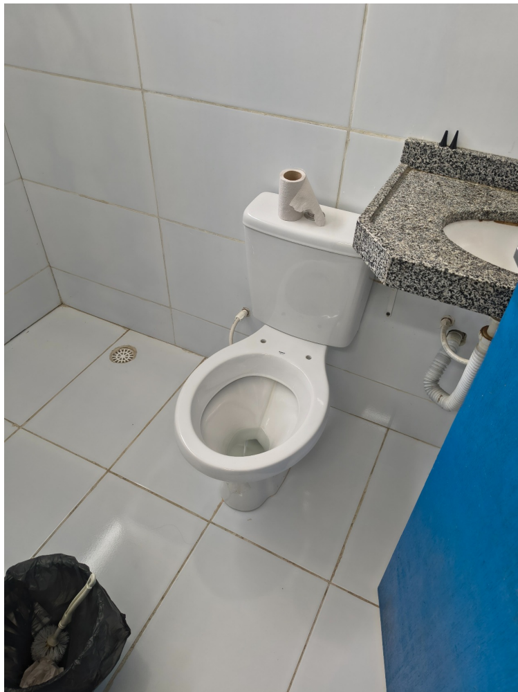
Banheiro anexo ao consultório médico com vaso sanitário sem tampa
