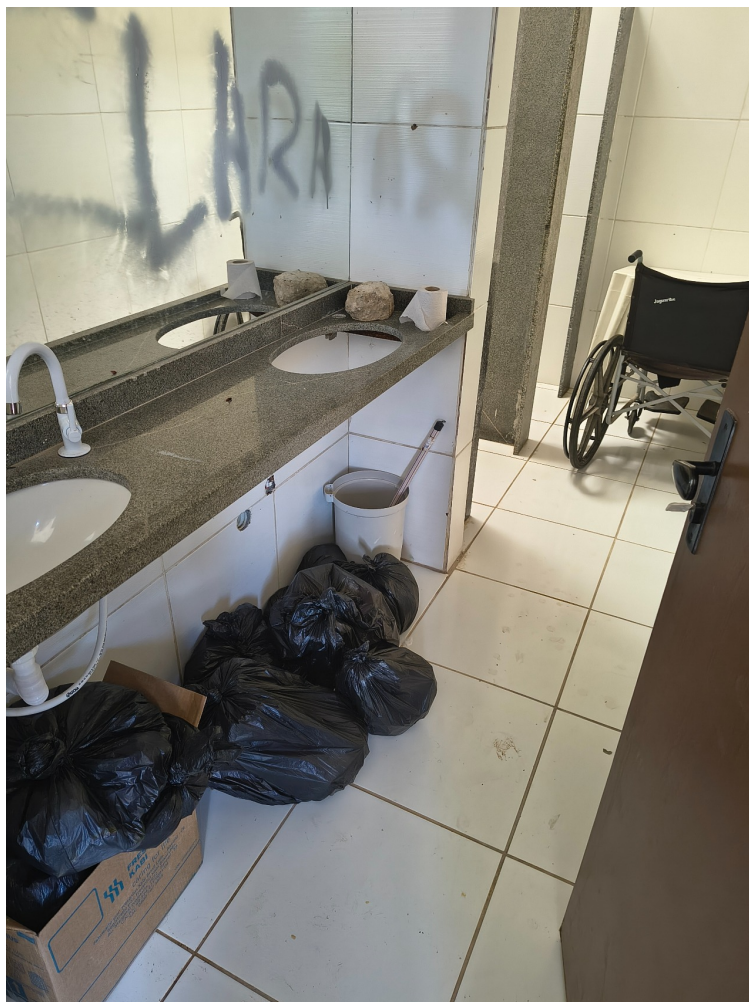
Banheiro único para usuários interditado, sem condições de uso.
