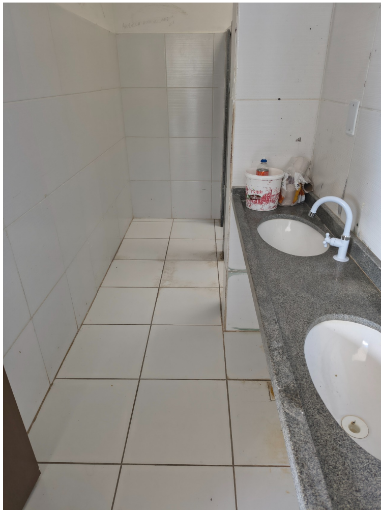
Banheiro um único valor também interditado e sem condições de uso.
