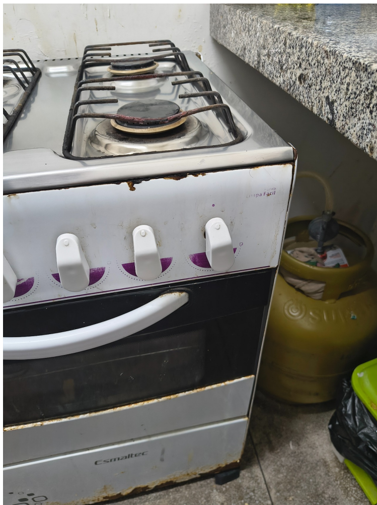
Fogão da copa/ cozinha: botijão de gás fica no interior do ambiente
