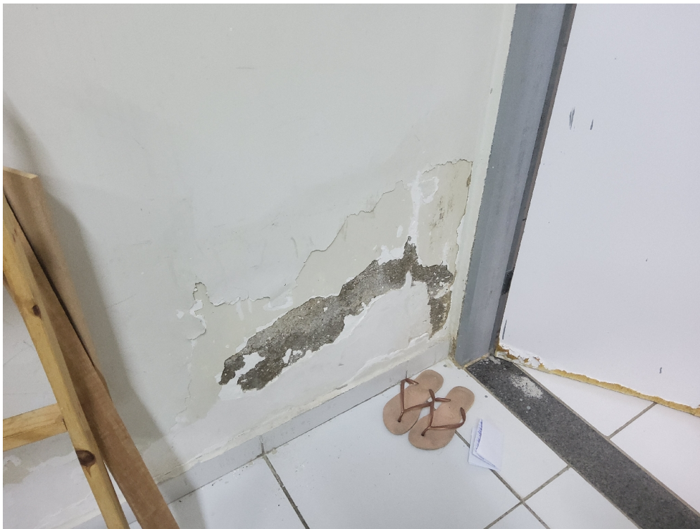
REPOUSO MÉDICO - observar reboco caindo
