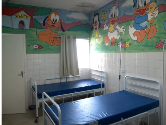
28.7. Enfermaria pediátrica; observar infiltração no teto
