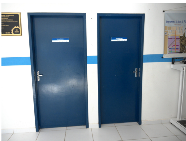
22.2. Algumas portas não possuem largura adequada para a passagem de cadeira de rodas
