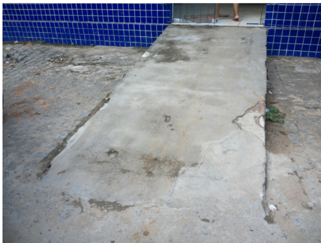
22.1. Rampa de acesso sem corrimão.
