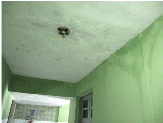
25.2. Instalações prediais com rachaduras, mofos e/ou infiltrações
