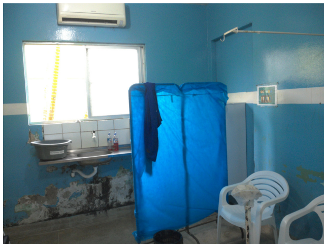
27.1. Sala de medicação (observar infraestrutura precária)
