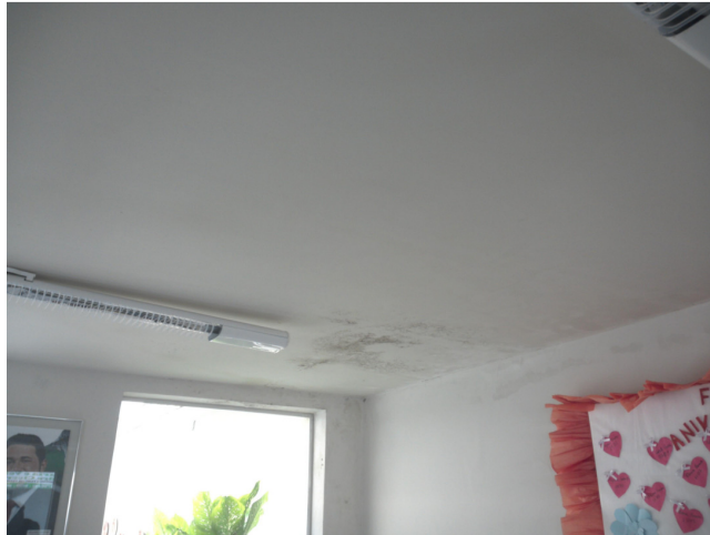
34.1. Presença de mofo e/ou infiltrações
