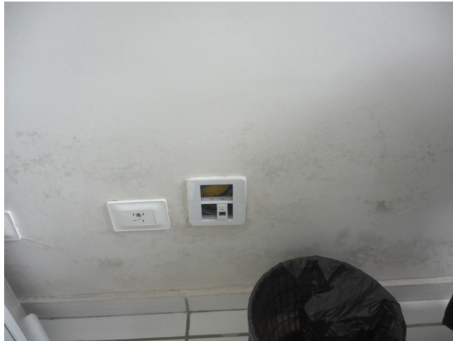
28.1. Instalações elétricas não compatíveis com a segurança do paciente
