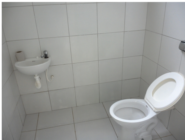
28.2. Banheiro com acessibilidade inadequada (falta corrimão)
