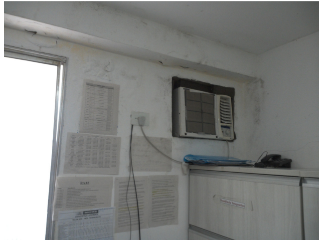
32.1. Instalações prediais com de trincas, rachaduras, mofos e/ou infiltrações
