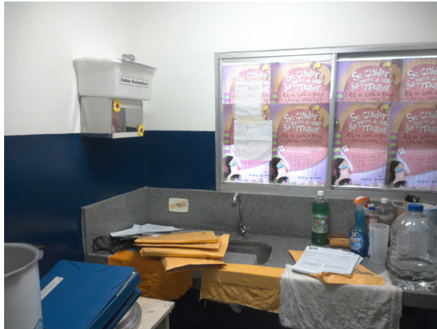
27.1. Sala de expurgo / esterilização não adequada
