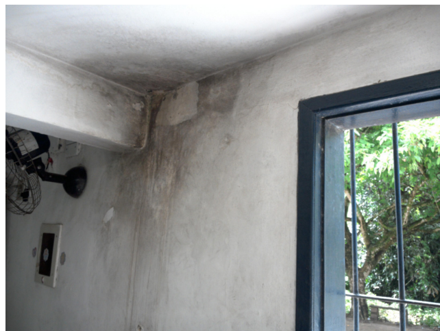
31.2. Mofo e infiltração
