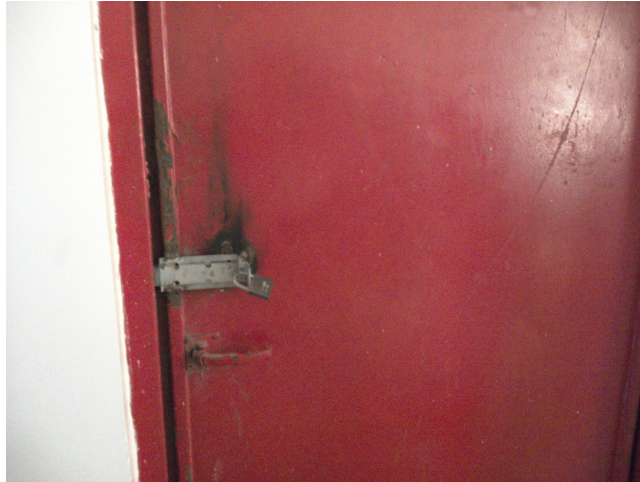
21.3. Porta de incêndio trancada com cadeado junto ao quarto dos médicos
