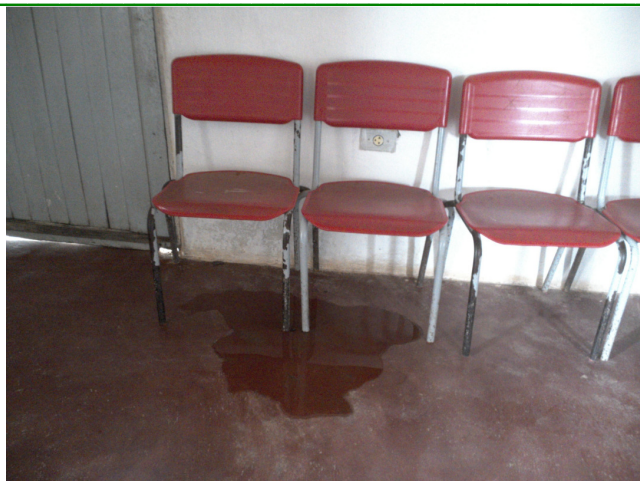
20.3. Água proveniente do vazamento do telhado
