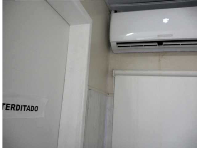
13.3. Consultório médico - Ar condicionado tipo split
