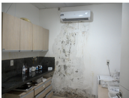
43.11. Sala de medicação (observar infiltração)
