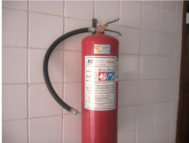
27.13. Extintor de incêndio
