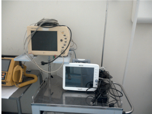
35.9. Equipamentos da sala vermelha fora da tomada
