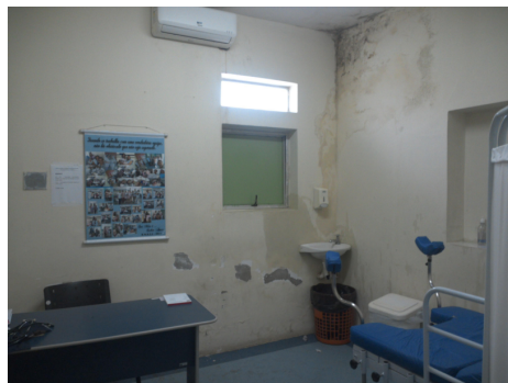
35.11. Triagem obstétrica (observar infiltração)
