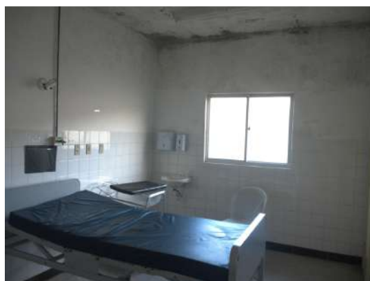
65.7. Alojamento conjunto (observar infiltração)
