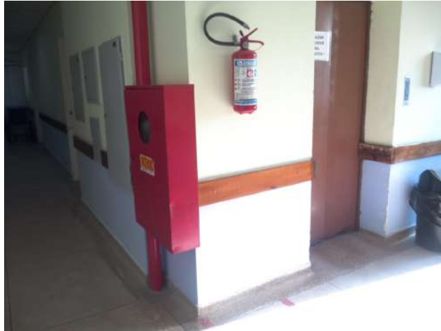
12.23. Extintor de incêndio e mangueira
