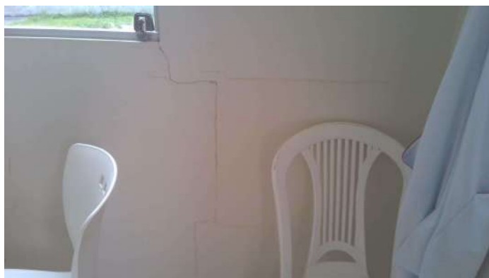
39.12. Rachadura no consultório médico
