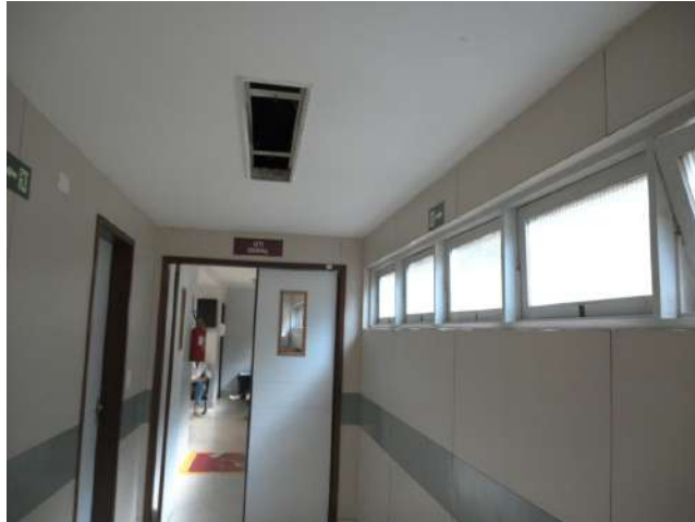
17.28. Buraco no teto no corredor de acesso a UTI - junto a sala de estar.
