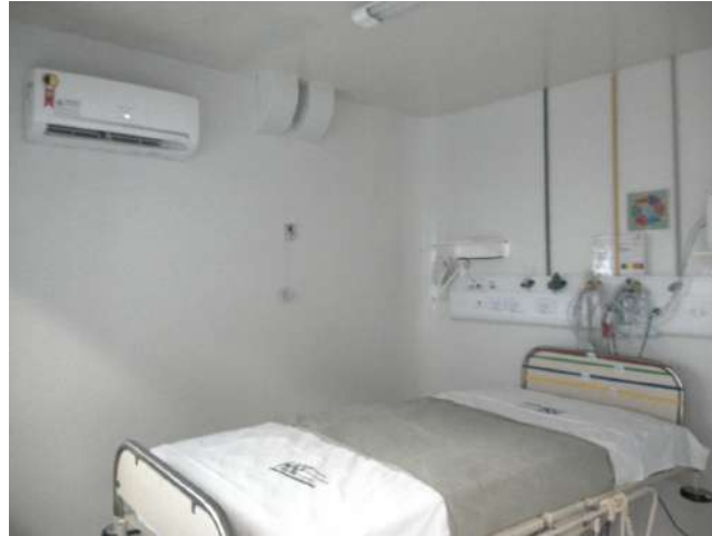
17.37. Leitos de isolamento com ar condicionado tipo split
