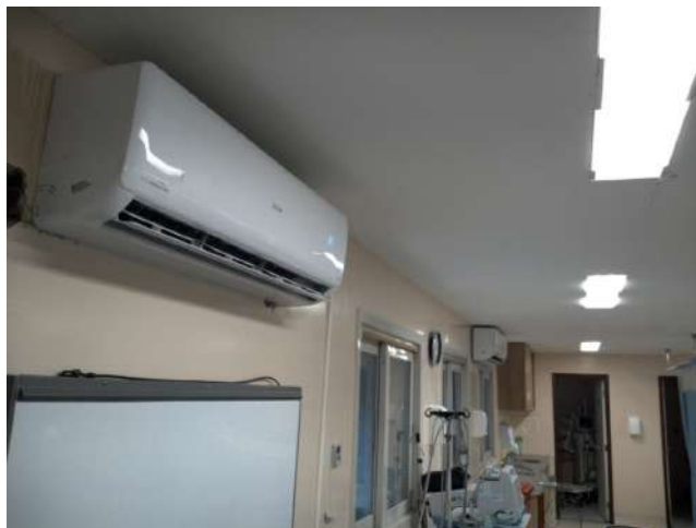
17.12. Climatização da UTI utilizando aparelhos de ar condicionado tipo split. Observar a presença de negatoscópio.
