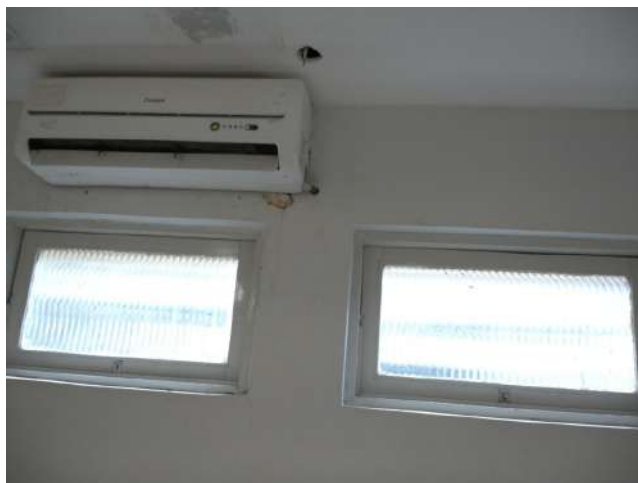
17.31. Aparelho de ar condicionado tipo split da sala de estar dos acompanhantes dos pacientes das UTIs 2 e 3
