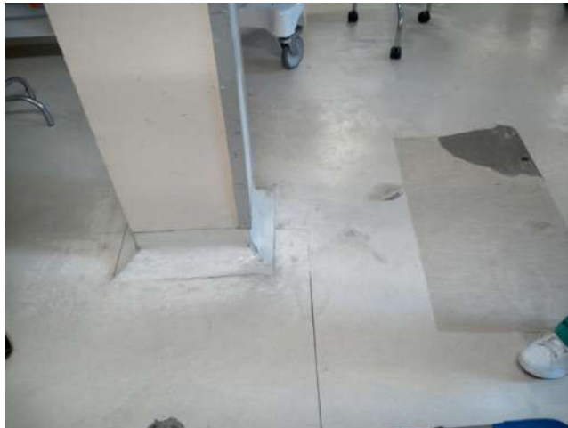
17.40. Falhas no piso da UTI 2
