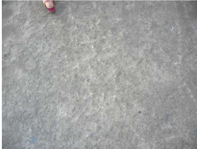
25.8. Rampa de acesso a triagem da maternidade com piso bastante irregular
