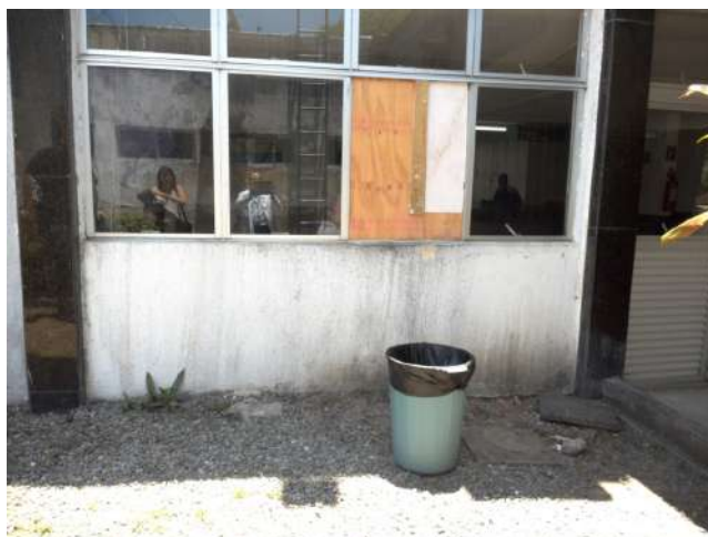
25.1. Entrada da maternidade interditada em virtude da reforma com lixo aberto
