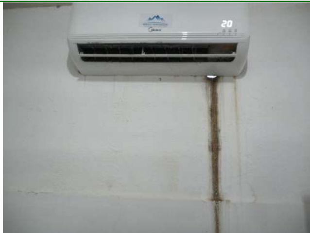
20.35. Ar condicionado tipo split + infiltração
