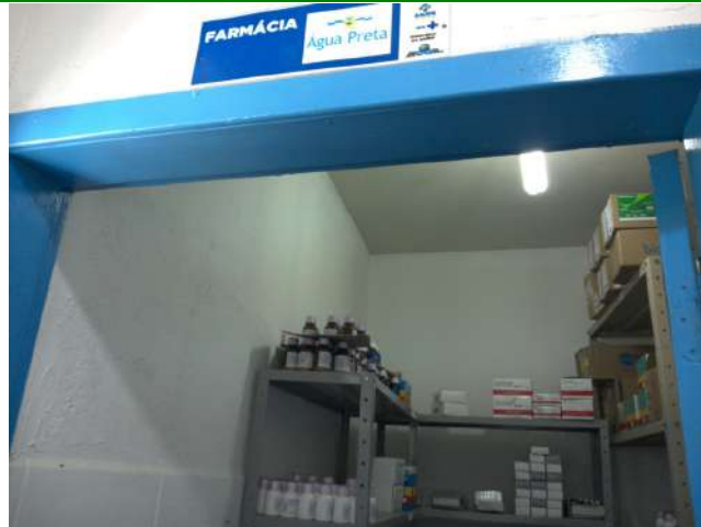
20.25. Farmácia sem climatização - Temperatura muito elevada (quente).
