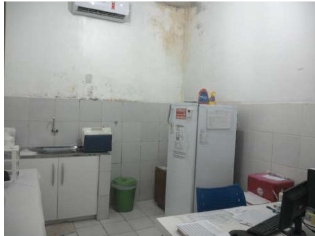
24.36. Sala de vacinas com sinais de infiltração
