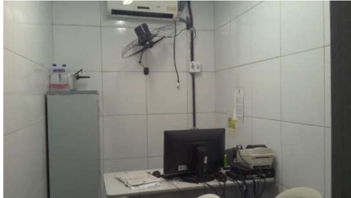
27.46. Regulação/Coleta de exames - Ar condicionado tipo split (sem funcionar). Sala sem aeração.
