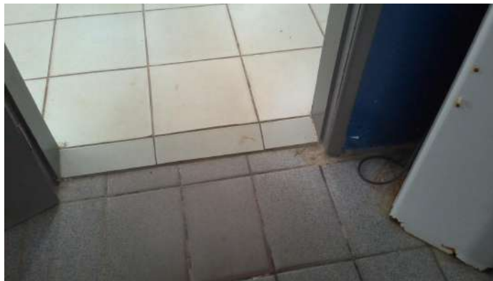
27.53. Acesso a "sala de reunião" - desnível no piso.
