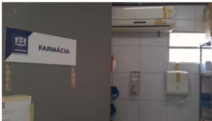
27.11. Farmácia - ar condicionado não está funcionando
