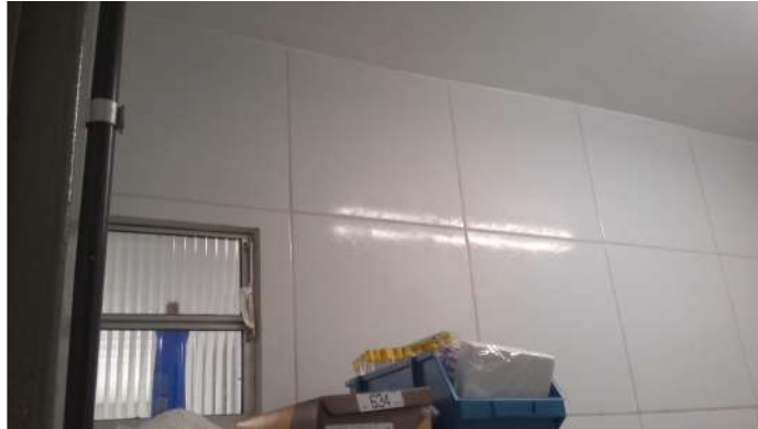
27.49. Sala de curativo - sem aeração
