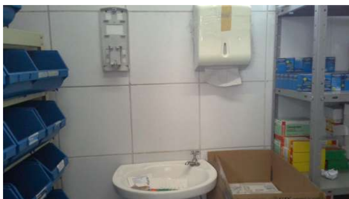
27.12. Farmácia - Pia com dispensador de sabão líquido quebrado e dispensador de papel toalha com fita adesiva
