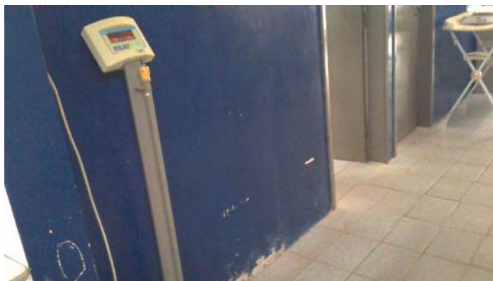
27.29. Balança no corredor - parede com falhas
