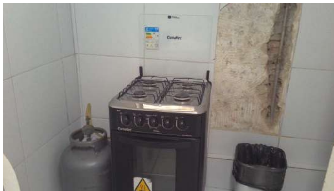
27.62. Copa/cozinha - botijão de gás interno
