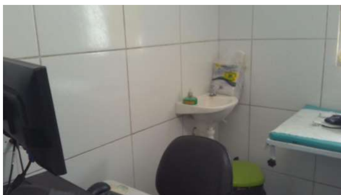
27.42. Consultório Médico com pia sem dispensador de sabão líquido e sem dispensador de papel toalha
