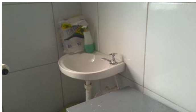
27.33. Consultório 01 - pia sem dispensador de sabão líquido e sem dispensador de papel toalha
