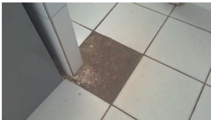
27.60. Entrada copa/cozinha - piso irregular
