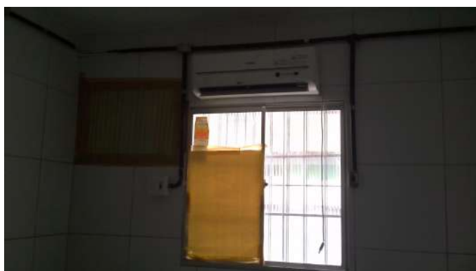
27.36. Consultório 01 - Ar condicionado tipo split
