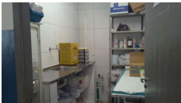
27.48. Sala de curativo (sem funcionar). Não possui aeração.
