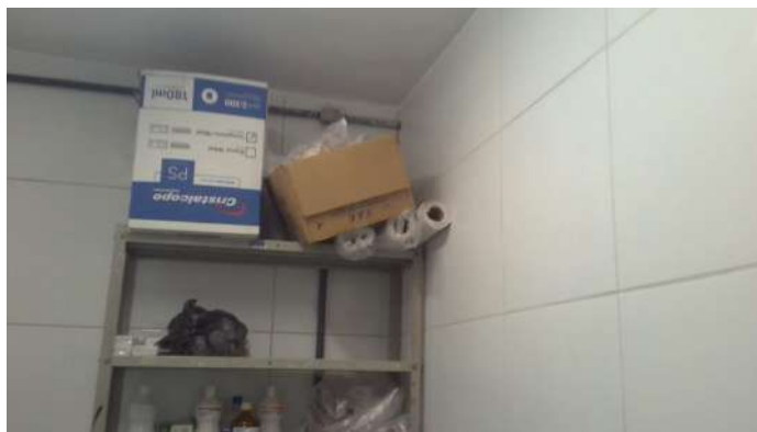
27.50. Sala de curativo - sem aeração
