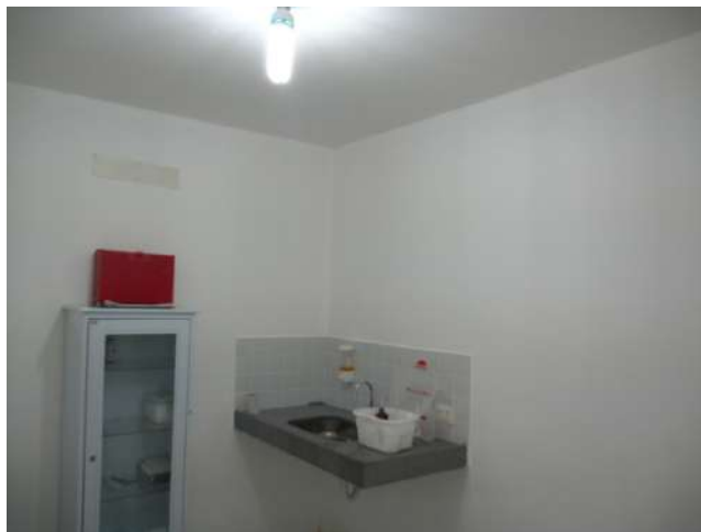
19.29. Sala de curativos sem nenhuma climatização
