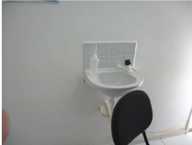
19.18. Pia do consultório de enfermagem sem dispensador de sabão líquido e sem papel toalha
