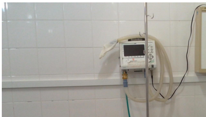
25.9. Equipamentos da sala vermelha
