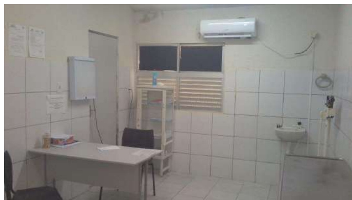
35.5. Consultório médico (observar infiltração)
