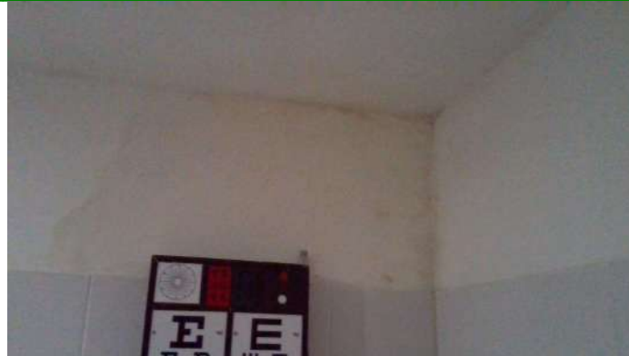
15.10. Infiltração na parede
