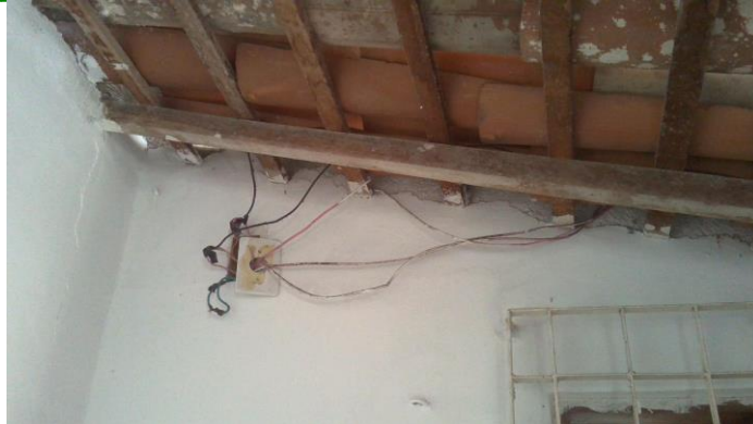
23.16. Fiação exposta na cozinha
