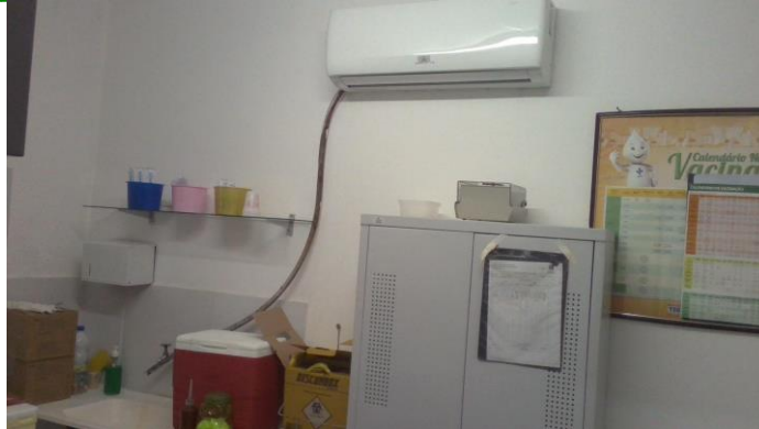
23.7. Arcondicionado sala de vacina (quebrado); observar drenagem para pia
