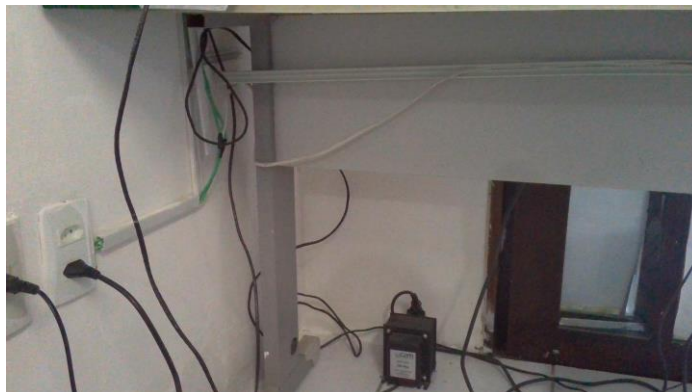
23.17. Fiação exposta na recepção
