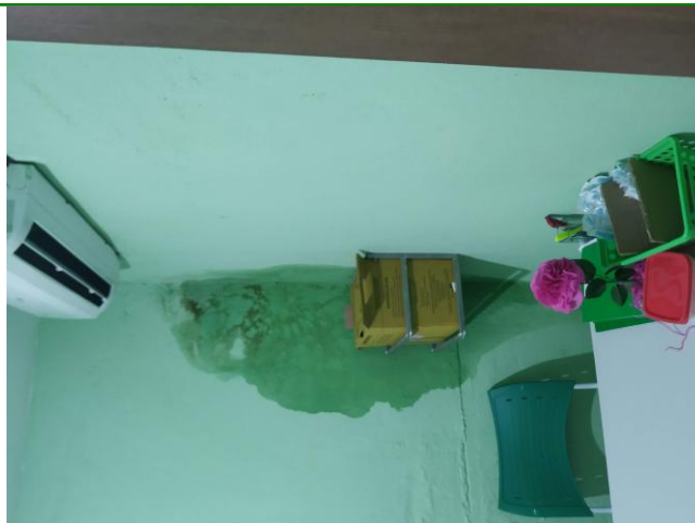
26.18. Estrutura física inadequada com infiltração
