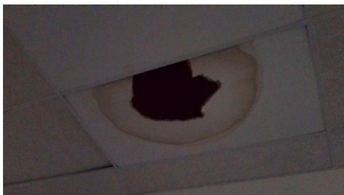
17.9. Teto danificado por infiltração após chuva (13.05.2021)
