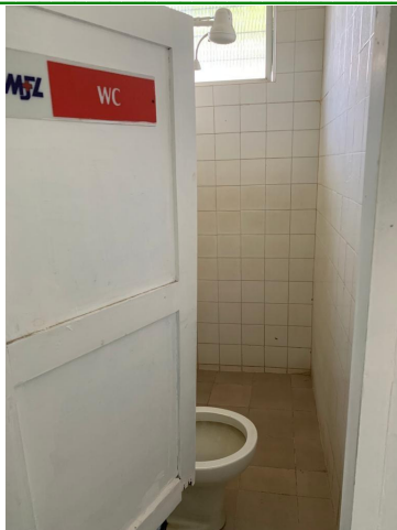
26.18. Enf Maternidade Banheiro
