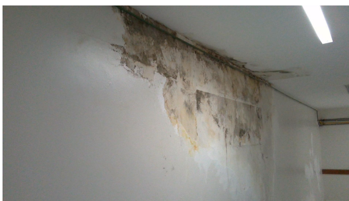
25.9. Parede com infiltração
