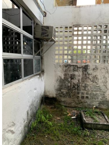
29.13. Infiltração Mofo sujo
