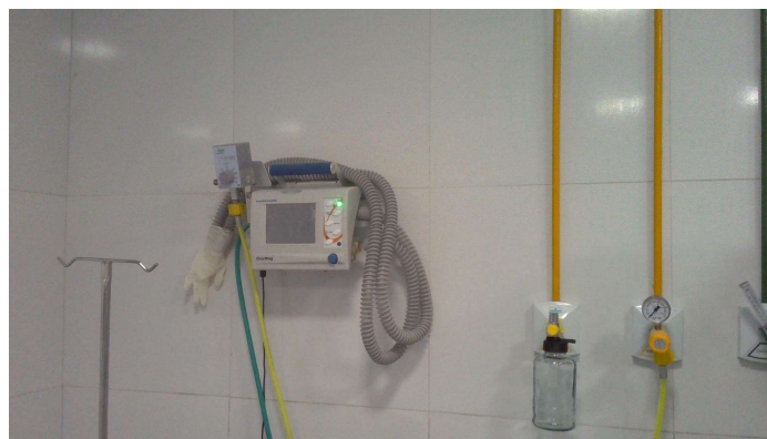
35.11. Sala vermelha (respirador e rede de gases canalizados)
