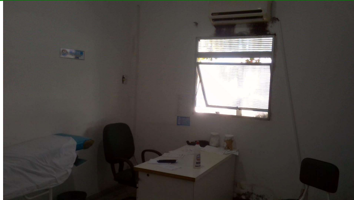
35.4. Paredes com infiltração
