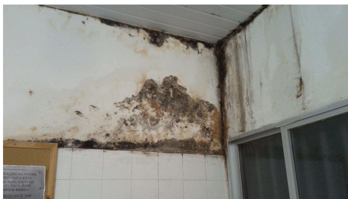
24.9. Infiltração na sala de medicação
