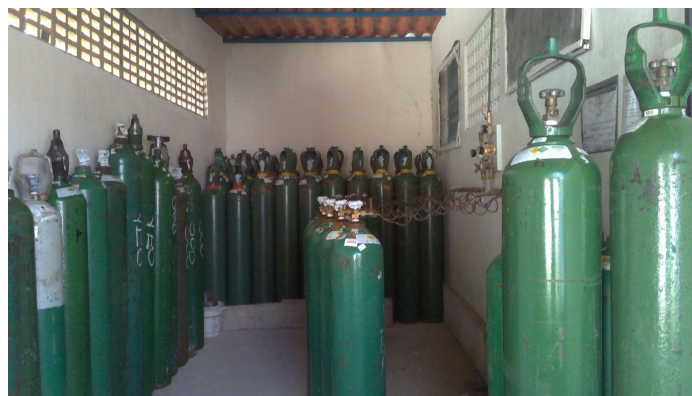
23.41. Local de armazenamento de oxigênio
